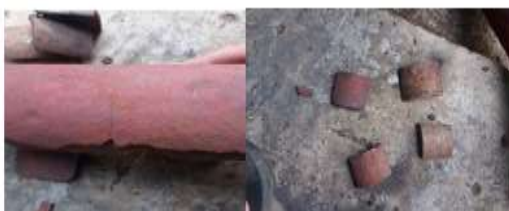
Gambar 1. Pipa Tidak standar
